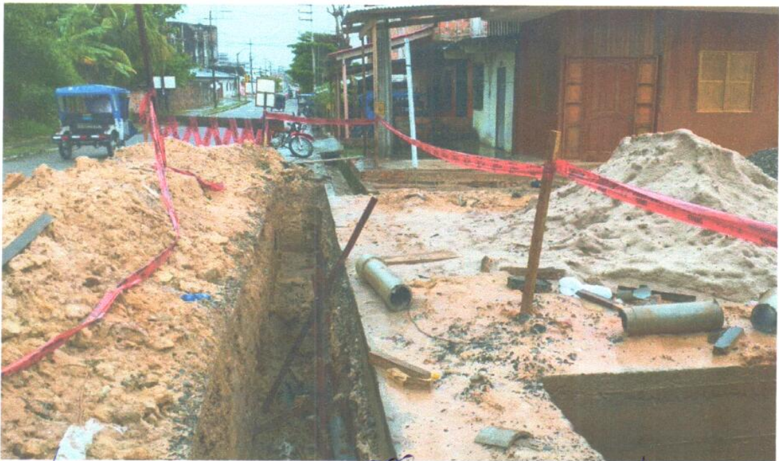
TUBERIA PVC UF 160mm C-7.5 REEMPLAZANDO A TUBO DE ASBESTO CEMENTO EN CALLE UCAYALI.
