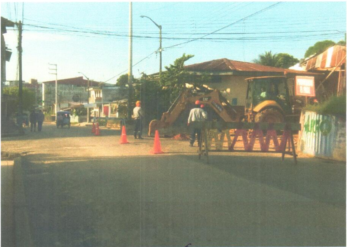
SEÑALIZACION EN ESQUINA PARA EXCAVACION E INSTALACION DE LA TUBERIA DE DESAGUE.
