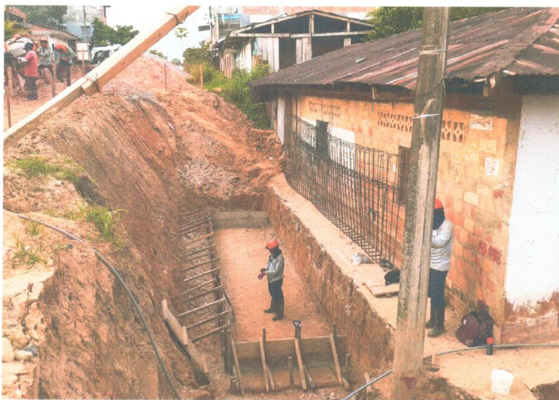
ENCOFRADO DE ZAPATA PARA MURO DE CONTENCION N°2 FRENTE A CALLE AMAZONAS.
